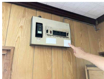
「震災の時、あれがいけなかった」などと言われて交換を勧められ、契約した女性宅の分電盤。家族構成なども聞かれ、心配になったという＝8月
